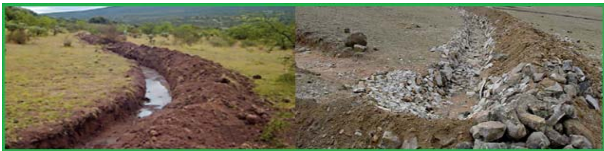
Fig. 10 Se ilustra una zanja de derivación recién excavada a la izquierda y una vez cabeceada para evitar arrastre de sedimentos a la derecha.
