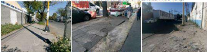
Imagen 100. Estado de conservación de las banquetas en la zona del PPDU Vallejo
