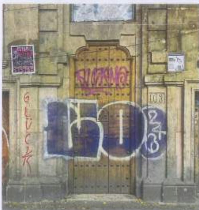
Casas abandonadas en calle Hamburga esquina Cooperativa
