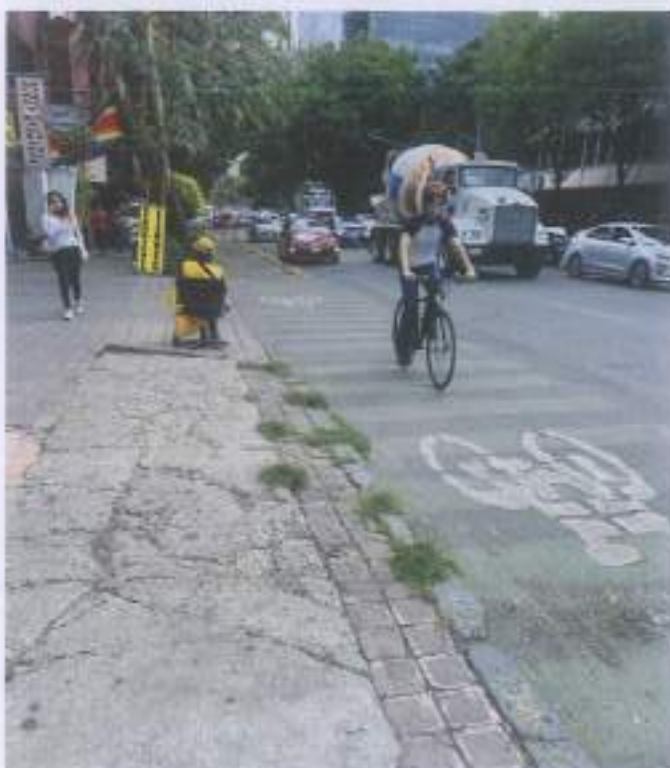
Estado actual de las banquetas en calle Niza
