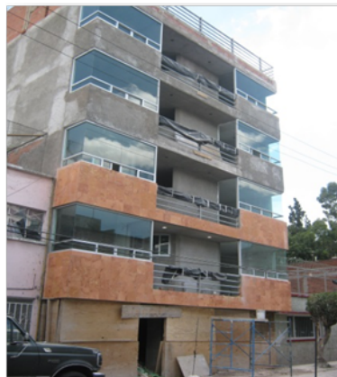
Figura 15. Construcción de seis niveles realizada sin autorización en la calle Lapsilázuli 39, Estrella
