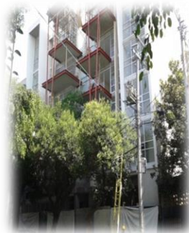
Figura 28. Construcción de seis niveles realizada sin autorización
