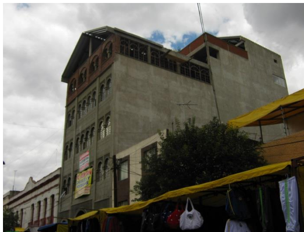
Figura 17. Construcción de un inmueble de siete niveles para uso de plaza comercial y bodega en el Centro Histórico
