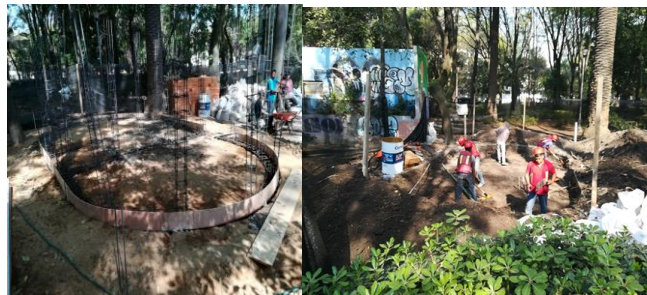
Imágenes fotográficas de los trabajos de desplante y cimentación del módulo de seguridad (10/12/2018).
