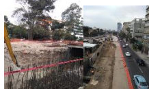
Imágenes fotográficas de la obra del deprimido Insurgentes-Mixcoac desde la avenida Río Mixcoac a la altura de Barranca del Muerto (31/8/2016).
