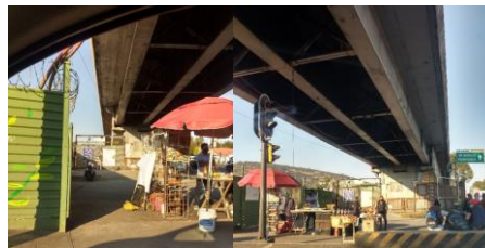
Se observa acceso al predio y personal de obra, que porta equipo de seguridad en las inmediaciones (21/1/2021).
