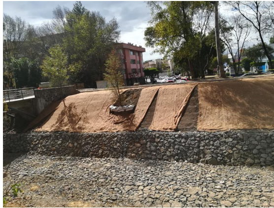
Imagen fotográfica del avance de los trabajos de mejoramiento de área verde y estabilización de arbolado (19/2/2020).
