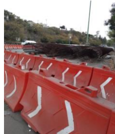
Imagen fotográfica de la vista del predio y material del Cetram Observatorio (17/1/2020).
