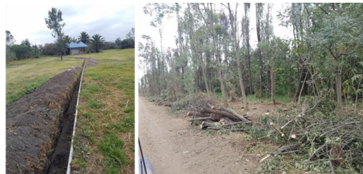
Se constató la instalación de un tubo de PVC para agua potable, así como derribos y podas de árboles en el PEX.
