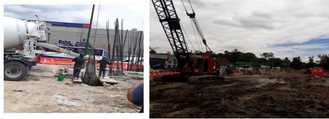
Imágenes fotográficas de los inicios de la obra del cuerpo puente (marzo 2018).
