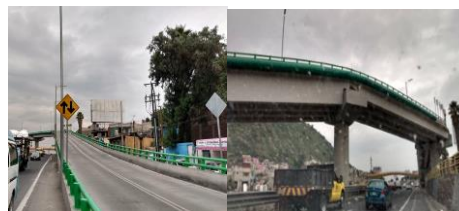
Imágenes fotográficas de la obra terminada desde autopista México-Puebla y Jorge Negrete (24/8/2020).
